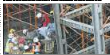
La bastida d'obra pesant de la plataforma de la minada va cedir i la bastida i el túnel van desaparèixer a la zona nord del túnel.
